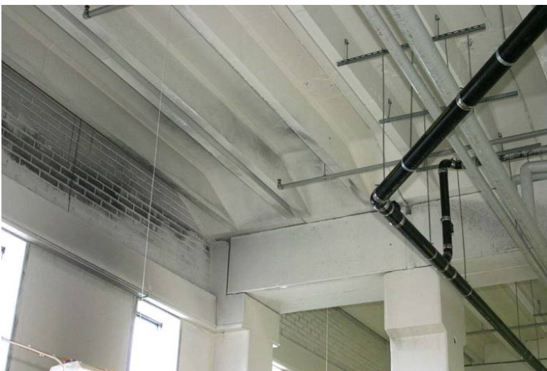
Bild 8. Två utlösta sprinklerhuvuden omedelbart ovanför brandplatsen. Takhöjd 6 m. (foto Claes Arnheim)
