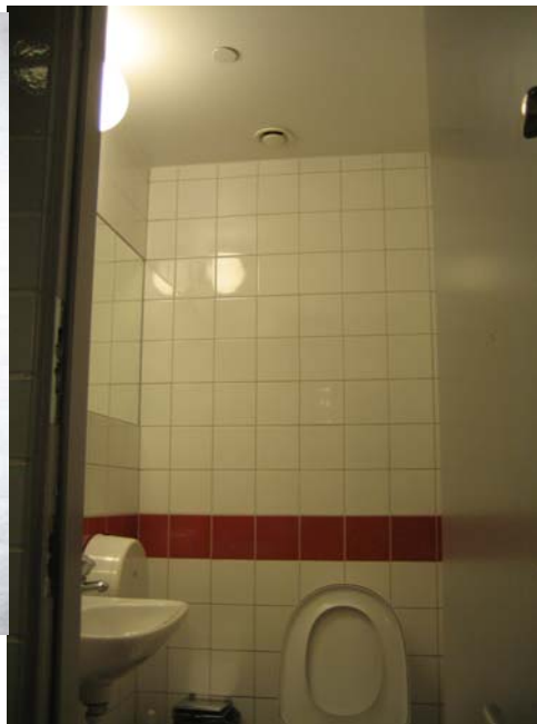
Bild 7. Dold sprinkler i tak som släckte branden
