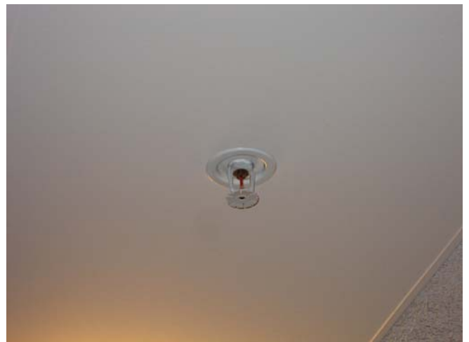
Bild 5. ”68 grader Snabbsprinkler” i korridor och klassrum
