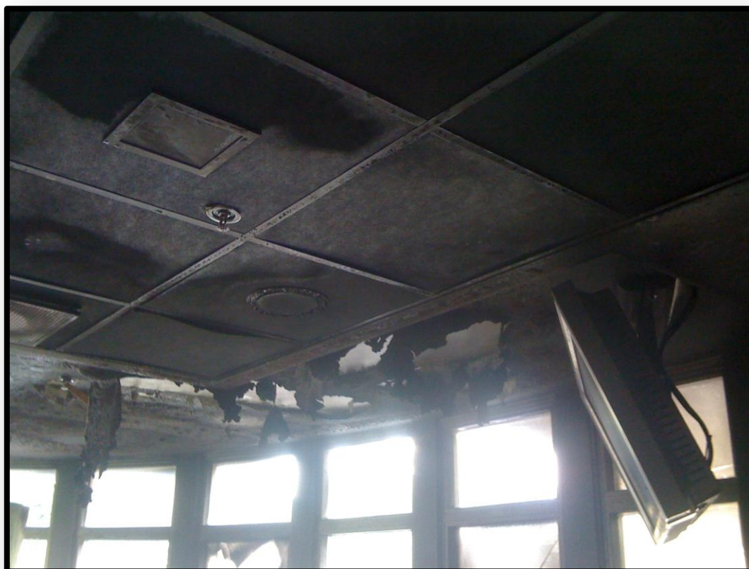
Bild 7. Sex sprinklers aktiverades av branden och släckte den anlagda branden där brandfarlig vätska användes
