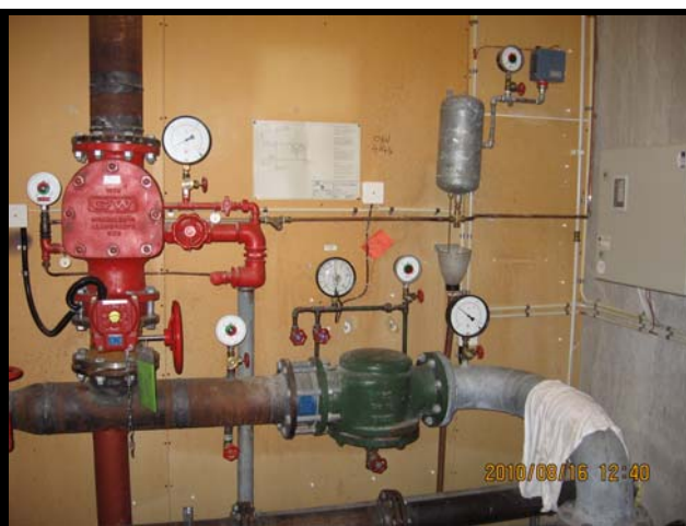
Bild 2. Ett sprinklerskyddat köpcentrum
