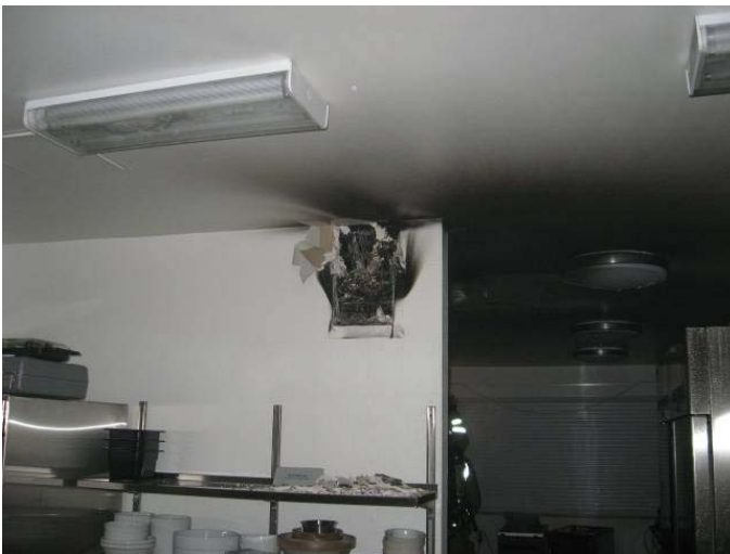
Fig. 3 – Elcentralen i köket där branden började
