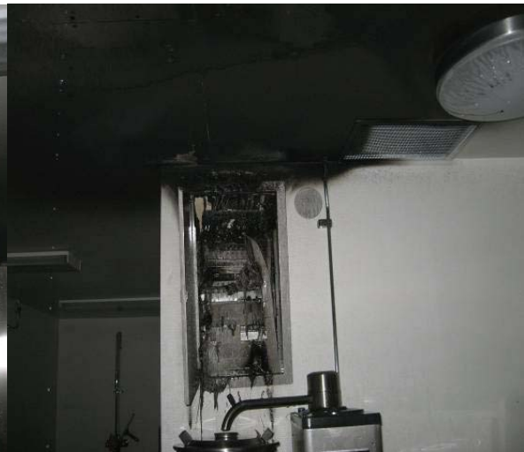
Fig. 4 – Branden släckt av ett sprinklerhuvud
