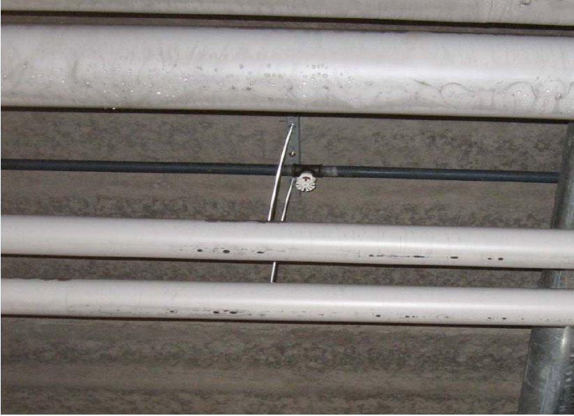
Bild 2. Det aktiverade sprinklerhuvudet efter släckningen med sot- & vattenrester på rören
