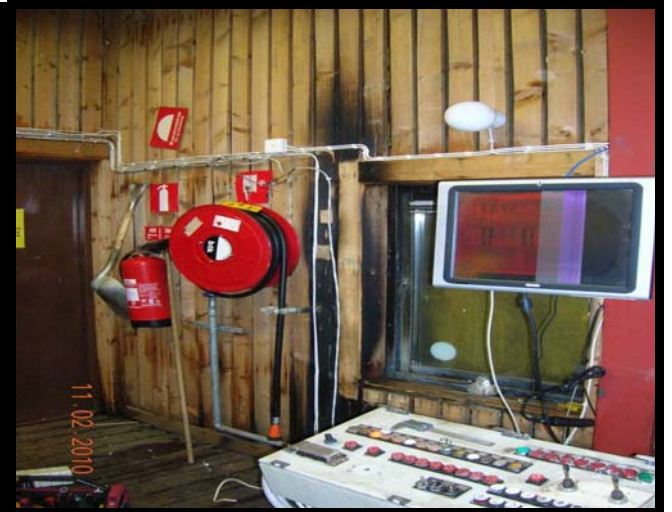
Bild 4. Brandskadad vägg i våningen över brandstart
