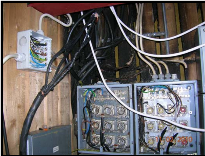
Bild 3. Detalj av den brandskadade elcentralen
