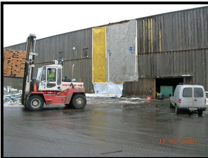
Bild 5. Den brandskadade ytterväggen
